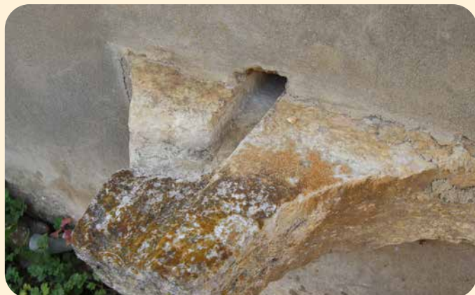
Une évacuation d'évier à Planches
